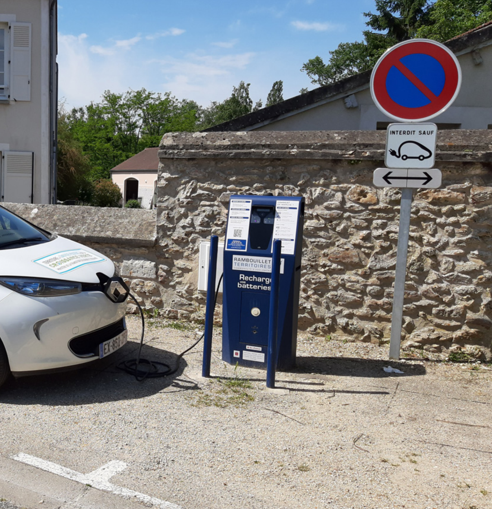
Borne de recharge pour véhicules électriques – Clairefontaine-en-Yvelines, Yvelines
