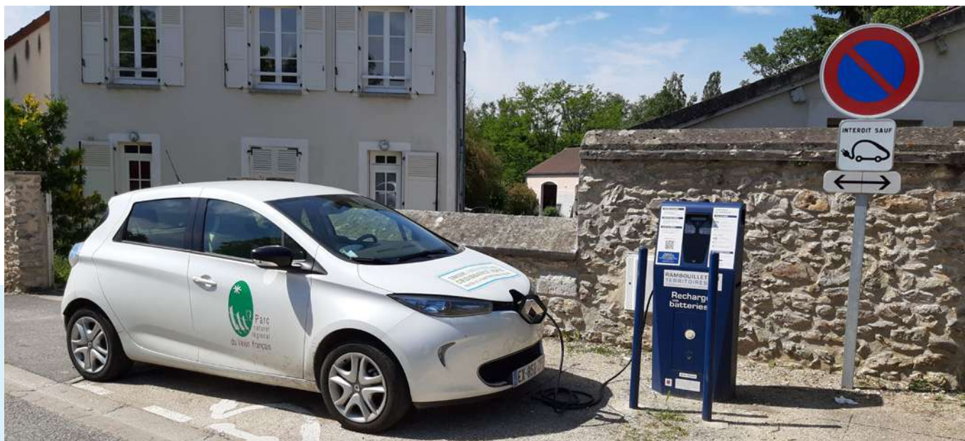
Borne de recharge pour véhicules électriques – Clairefontaine-en-Yvelines, Yvelines
